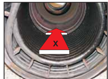
Abb. 6.24: Innenansicht der Heizschlange von unten
