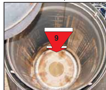
Abb. 6.25: Innenansicht des Wärmetauschermantels von oben
